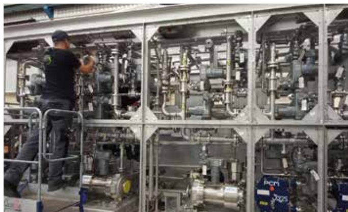
SKID UMTEC (traitement d'effluents).
